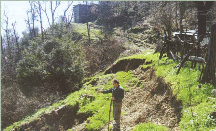
Βύθισμα και κατολίσθηση παραπλεύρως της δεξαμενής.
